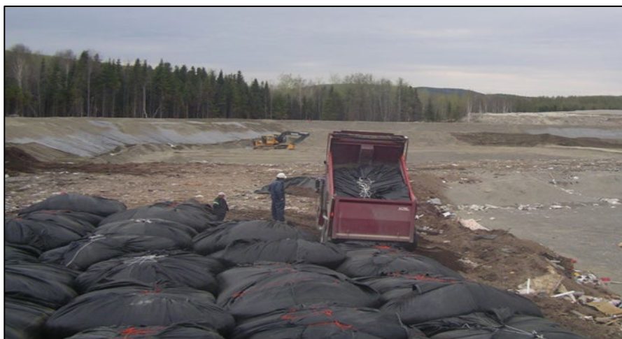
Figure 3 – Disposition des résidus d'enrobé amianté dans un LET
