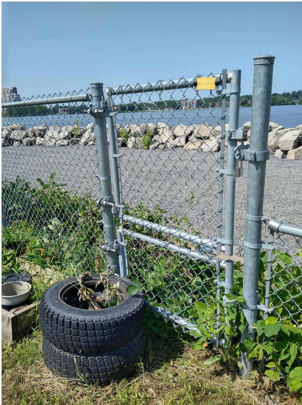
Photo 2: L'une des portes de service dans la clôture à l'arrière du CHSLD Berthiaume-du-Tremblay (photo de l'auteur).
