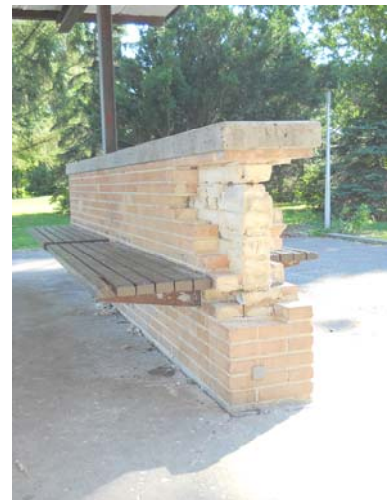
Figure 2. Vue présentant l'état de délabrement du mur le plus bas. Source : Arrondissement Ahuntesic-Cartierville.
