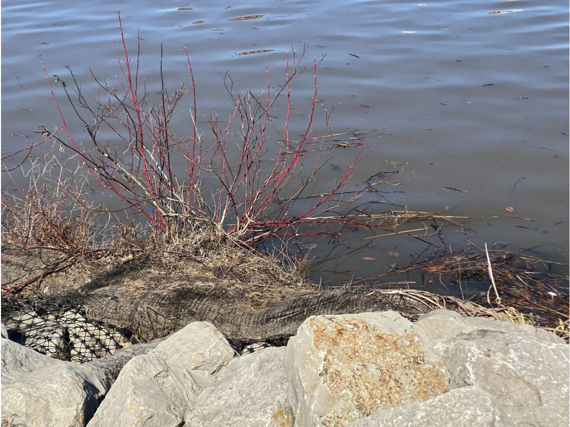
Filet installé lors de la plantation. Très nuisant pour la faune.
