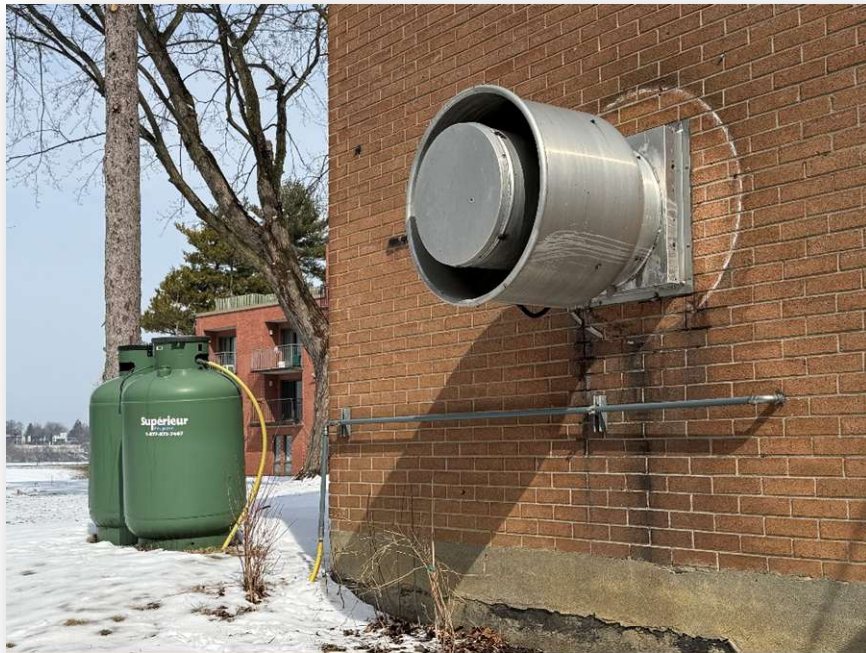
P18. Vue sur le ventilateur d'extraction de la cuisine et des réservoirs de propane des cuisinières (résidence Ignace Bourget).
