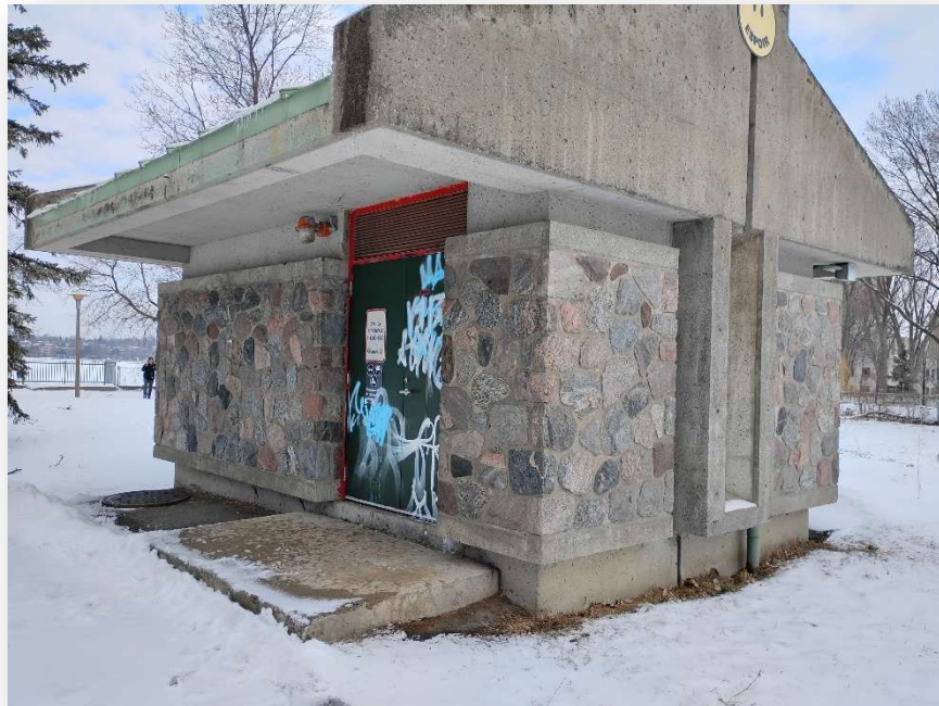
P8. Vue sur la station de pompage (parc Louis-Hébert).
