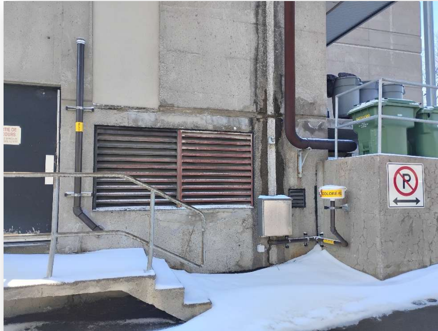
P15. Vue sur la tuyauterie de remplissage et d'évent d'un réservoir de diesel coloré sur la propriété voisine située au 1 635 boul. Gouin est .
