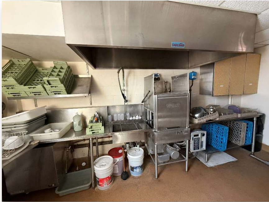
P17. Vue sur la hotte d'aspiration de la salle de plonge (résidence Ignace Bourget).
