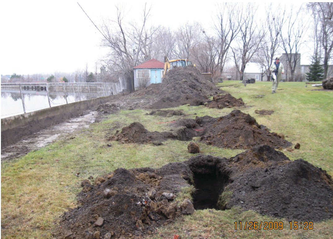
Figure 14 – Photo datée du 26 novembre 2009 permettant de constater qu’au moins trois petites tranchées (test pit) ont été excavées sur l’ancien terrain des sœurs de Miséricorde (Archives d’Hydro-Québec)
