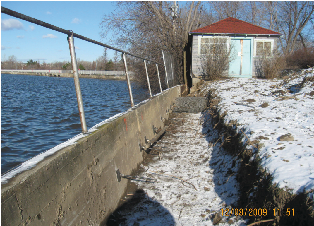
Figure 13 – Photo datée du 8 décembre 2009 permettant de constater qu’une large tranchée a été ouverte sur l’ancien terrain des sœurs de Miséricorde en bordure du mur de soutènement (Archives d’Hydro-Québec)
