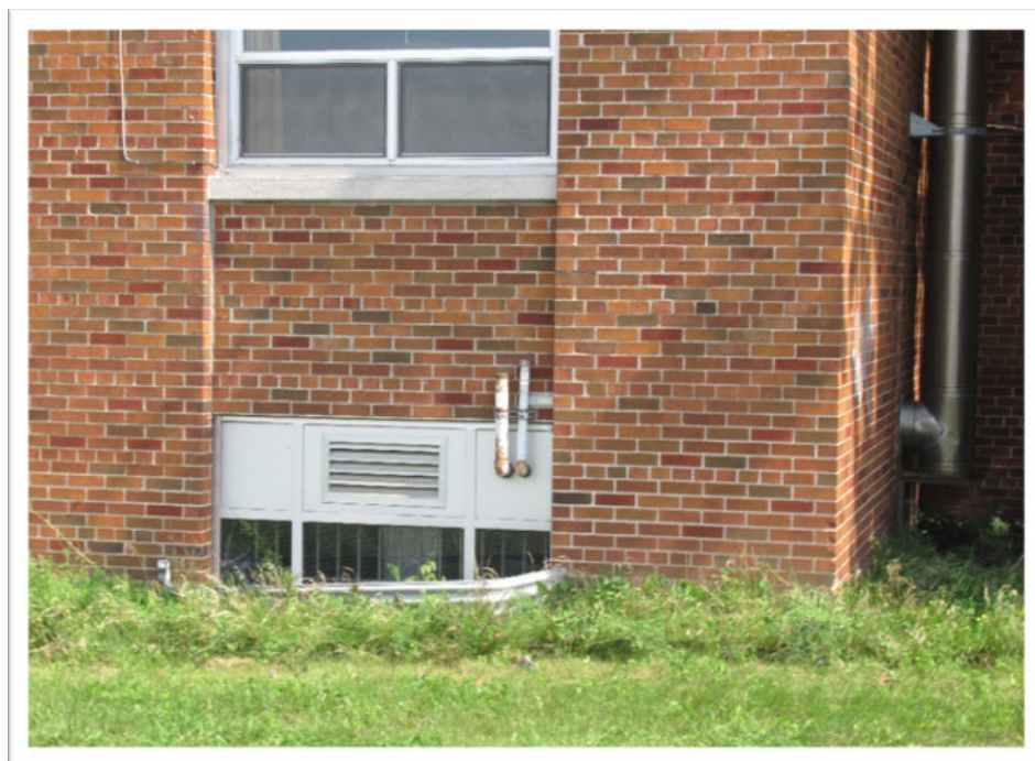
PHOTO 10 — Vue vers le sud des événements situés le long de la façade nord du bâtiment vacant dans le secteur des Sœurs de la Miséricorde (au 12375 rue du Fort-Lorette).
