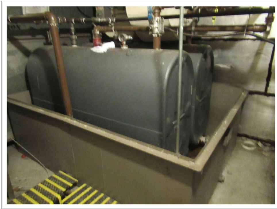
PHOTO 19 — Vue des deux réservoirs hors sol de diesel (à double paroi), d'une capacité de 1 137 L chacun, situés au rez-de-chaussée du bâtiment du CHSLD Berthiaume-Du Tremblay, dans une salle dédiée.
