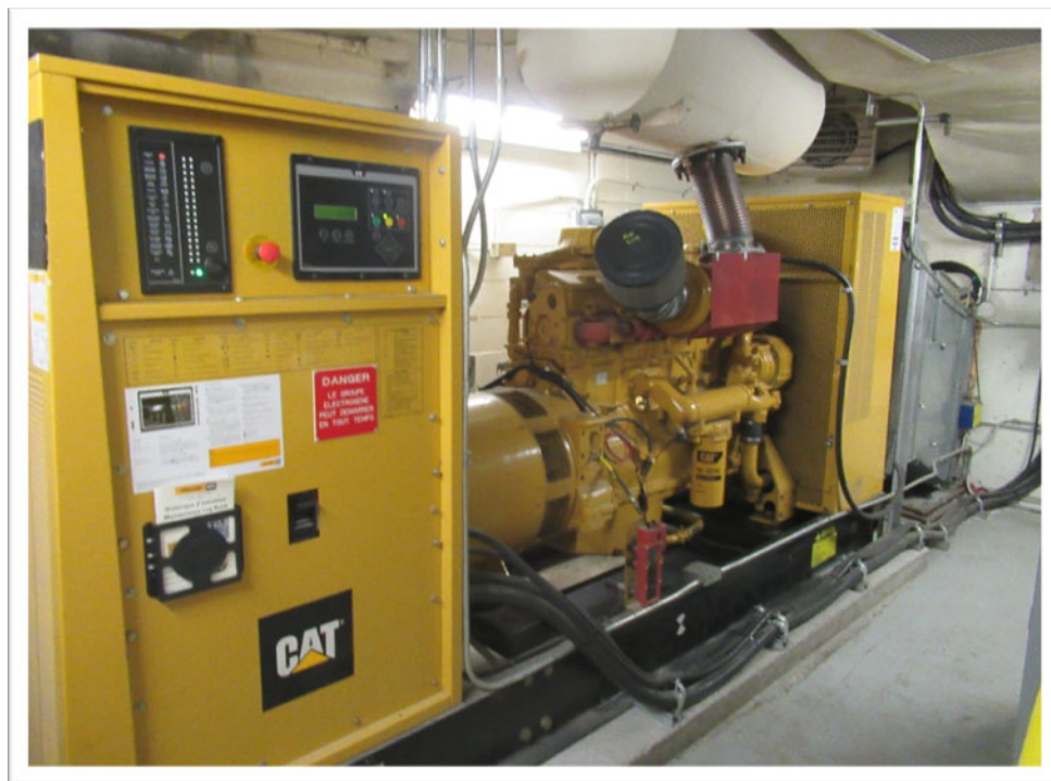
PHOTO 18 — Vue de la génératrice de secours, alimentée au diesel, située au rez-de-chaussée du bâtiment du CHSLD Berthiaume-Du Tremblay dans une salle dédiée (1615-1635 boulevard Gouin Est).
