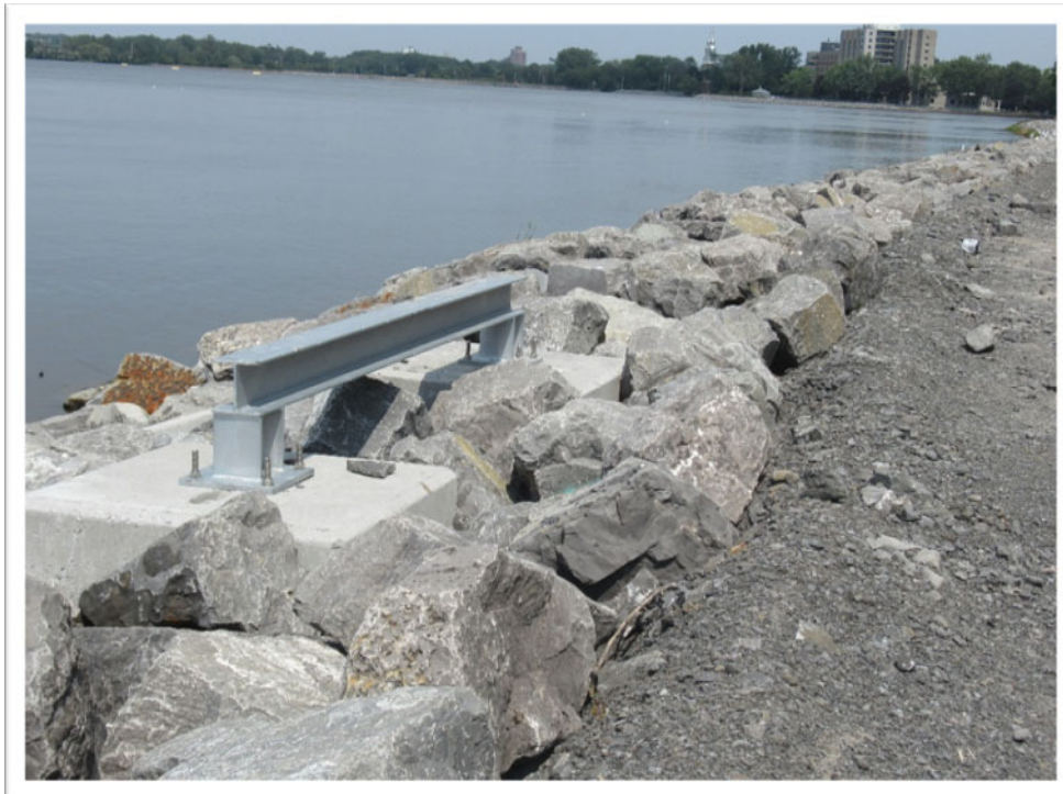
PHOTO 2 — Vue vers le nord-est de la structure du quai qui sera aménagé sur la rive sud, située dans le secteur de l'école Sophie-Barat (à l'emplacement du remblai d'enrochement, situé le long du mur de soutènement).
