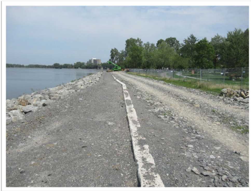
PHOTO 1 — Vue vers l'est de la portion ouest mur de soutènement situé dans le secteur de l'école Sophie-Barat.
