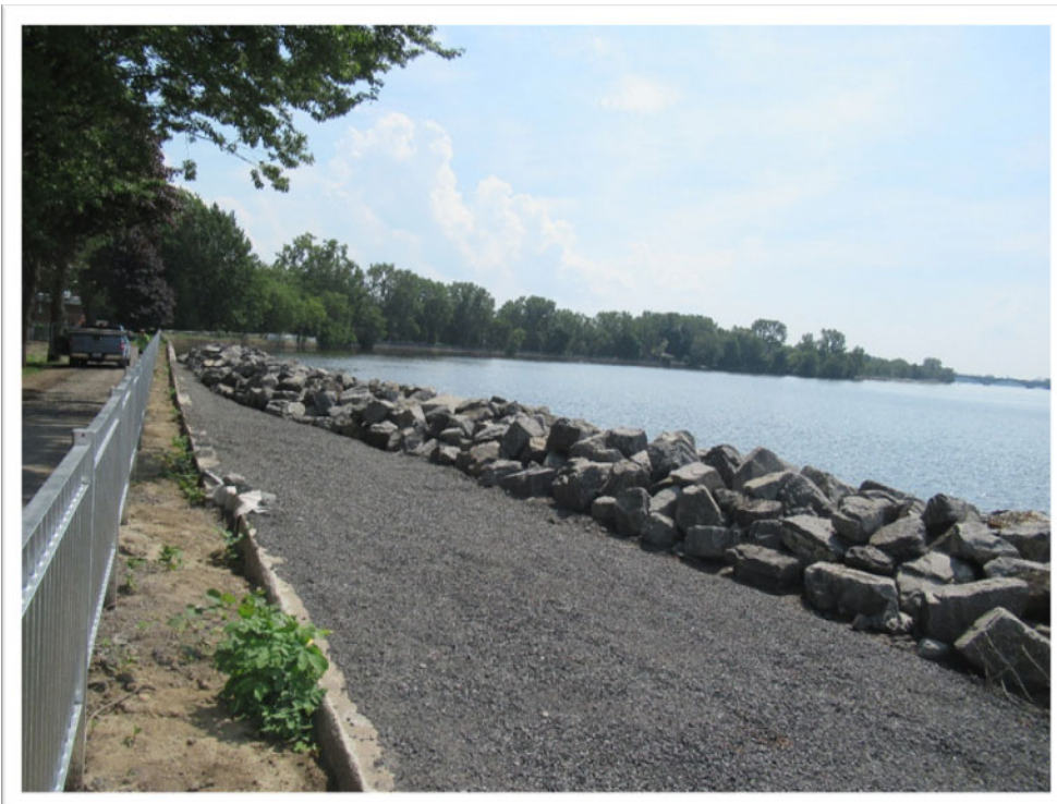
PHOTO 6 — Vue vers l'ouest de la section du mur de soutènement (incluant le remblai d'enrochement) située dans le secteur de la résidence Berthiaume-Du Tremblay (secteur est du site à l'étude).
