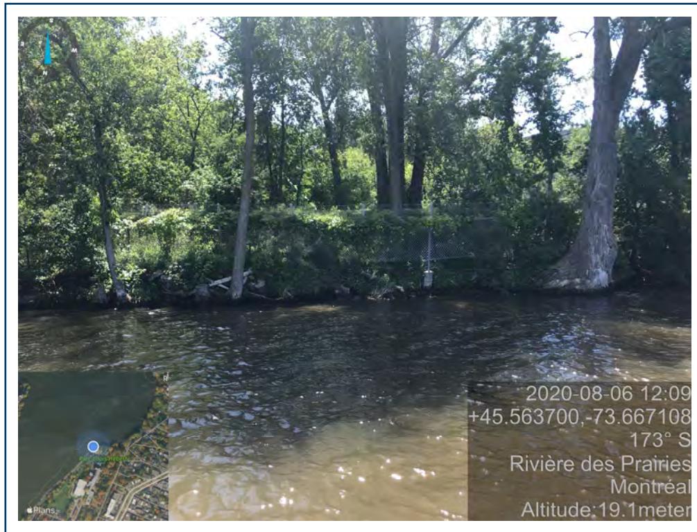
PHOTO 3 — Érosion de la berge au niveau du tronçon 5
