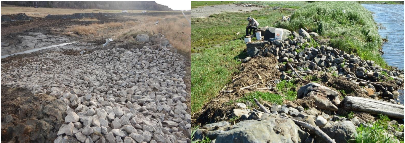
Figure 11-4 : Déversoir de l'ouverture consolidé après la réalisation en 2020 (gauche) et ouverture consolidée en juin 2021 (droite). Plusieurs débris ligneux et laisses de marées se sont déposés sur le tablier après les grandes marées automnales et printanières
