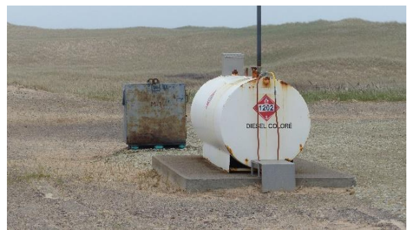
Photo 4. Réservoir hors sol de diesel situé au sud du dépôt d'explosifs (droit n° 113298)
