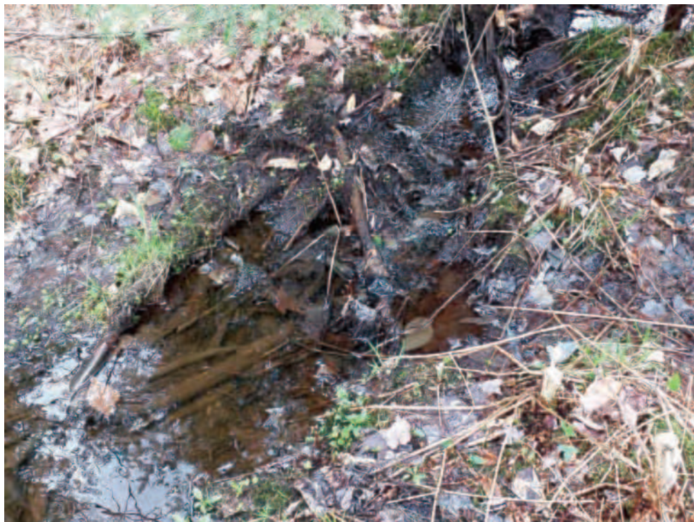
PHOTO 37 Obstacle embâcle du cours d'eau CE-168, segment S01, mai 2025
