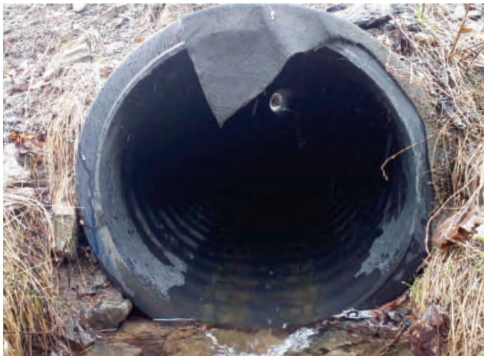
PHOTO 7 Obstacle ponceau du cours d'eau CE-173, mai 2025
