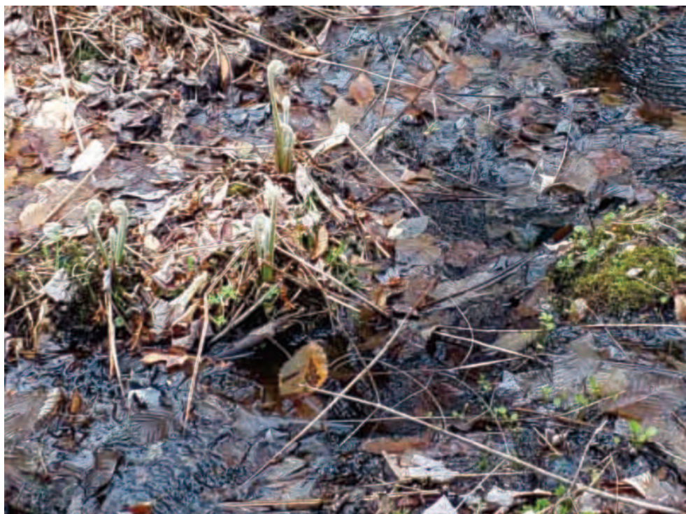
PHOTO 40 Obstacle embâcle du cours d'eau CE-168, segment S03, mai 2025
