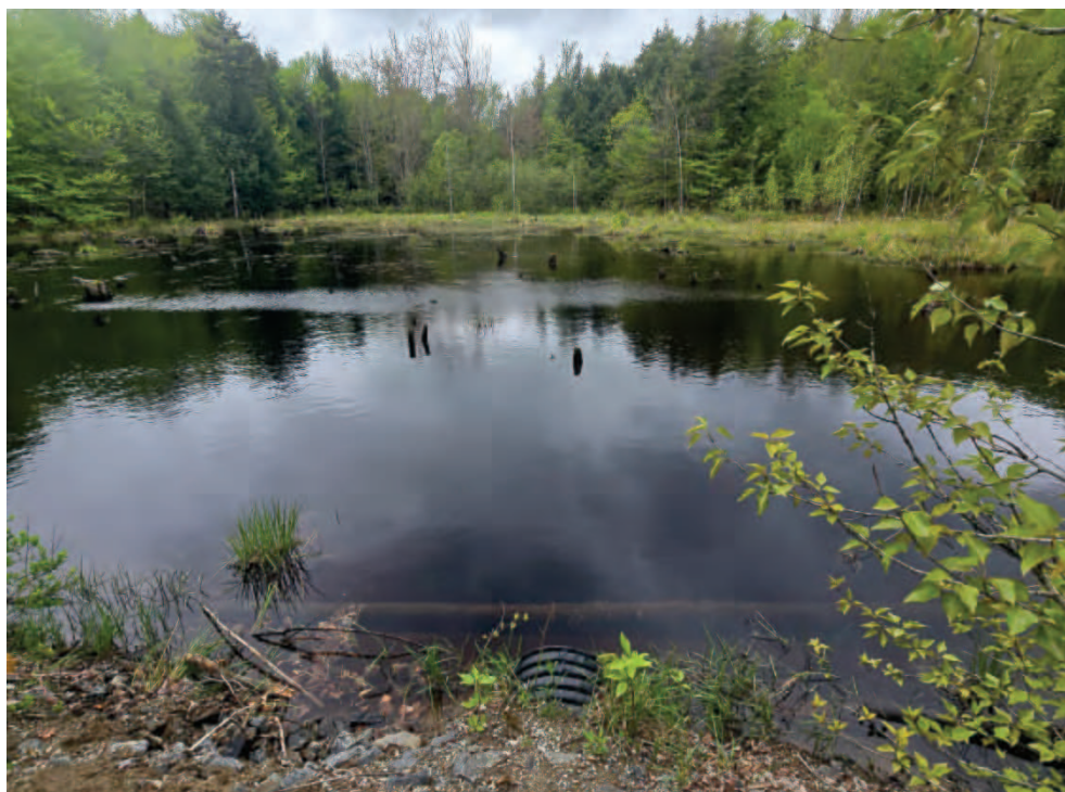
PHOTO 22 Ponceau limitant l'écoulement de l'eau dans le MH013, mai 2025
