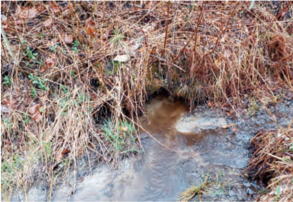
PHOTO 1 Obstacle souterrain du cours d'eau CE-005, segment S02, mai 2025
