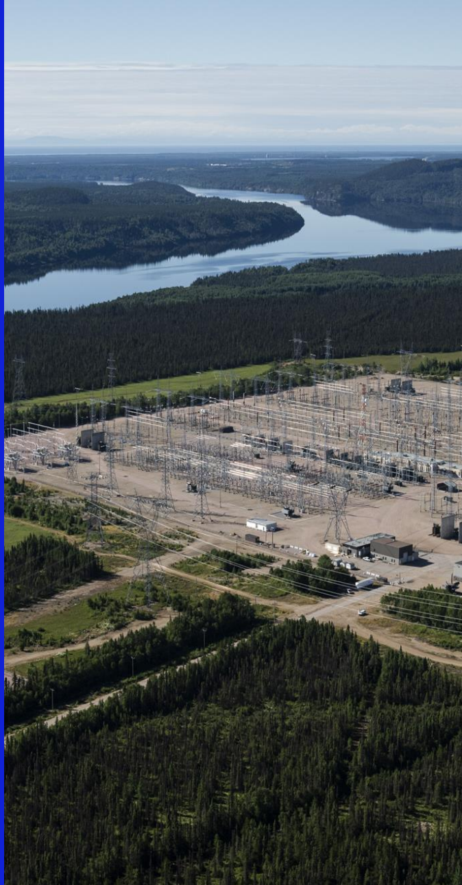
Poste Manicouagan 735-315 kV
