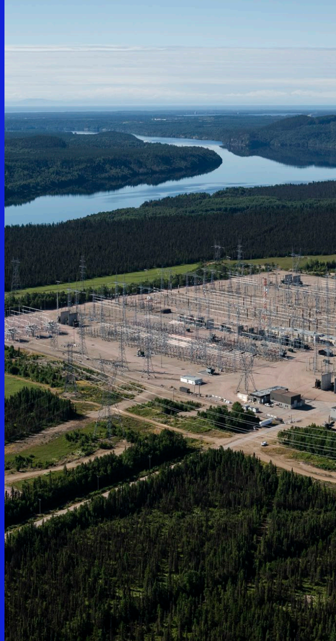
Poste Manicouagan 735-315 kV
