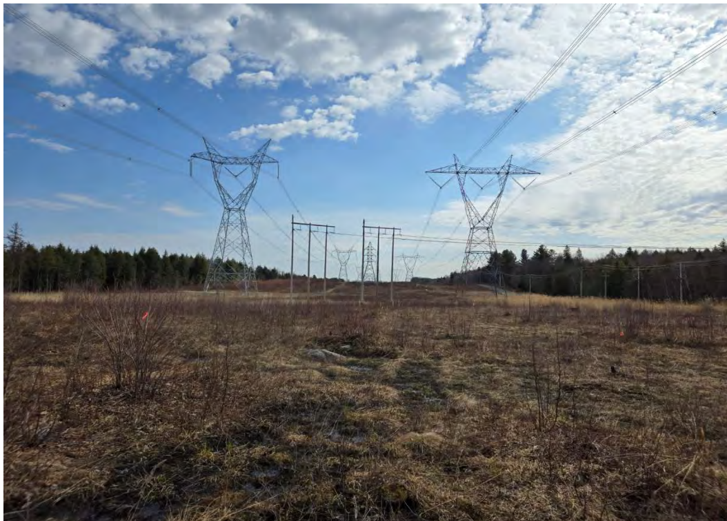
Photographie n°22. Pylônes électriques et poteaux de bois traité
