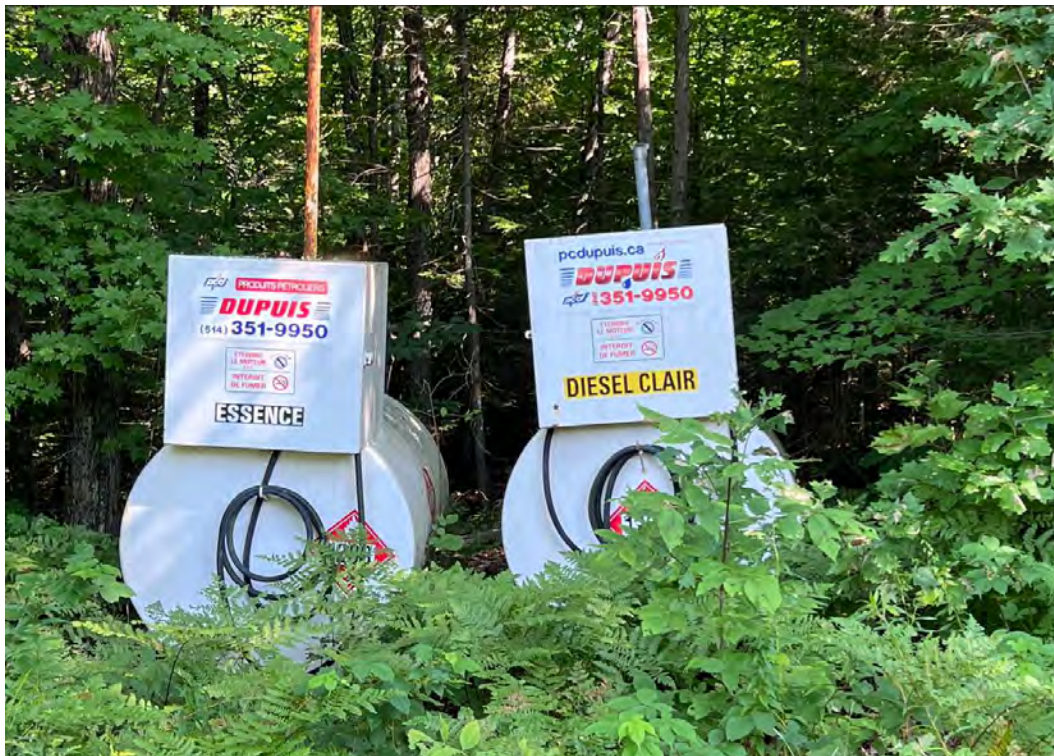
Photographie n°2. Réservoirs hors sol de produits pétroliers (essence et diesel)
