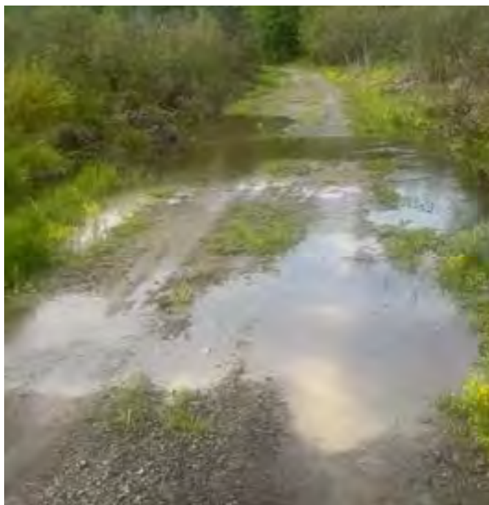
Inondation d'un chemin, causé par un ponceau partiellement bloqué par les débris d'un barrage de castor à proximité (47.41537, -68.51985)
