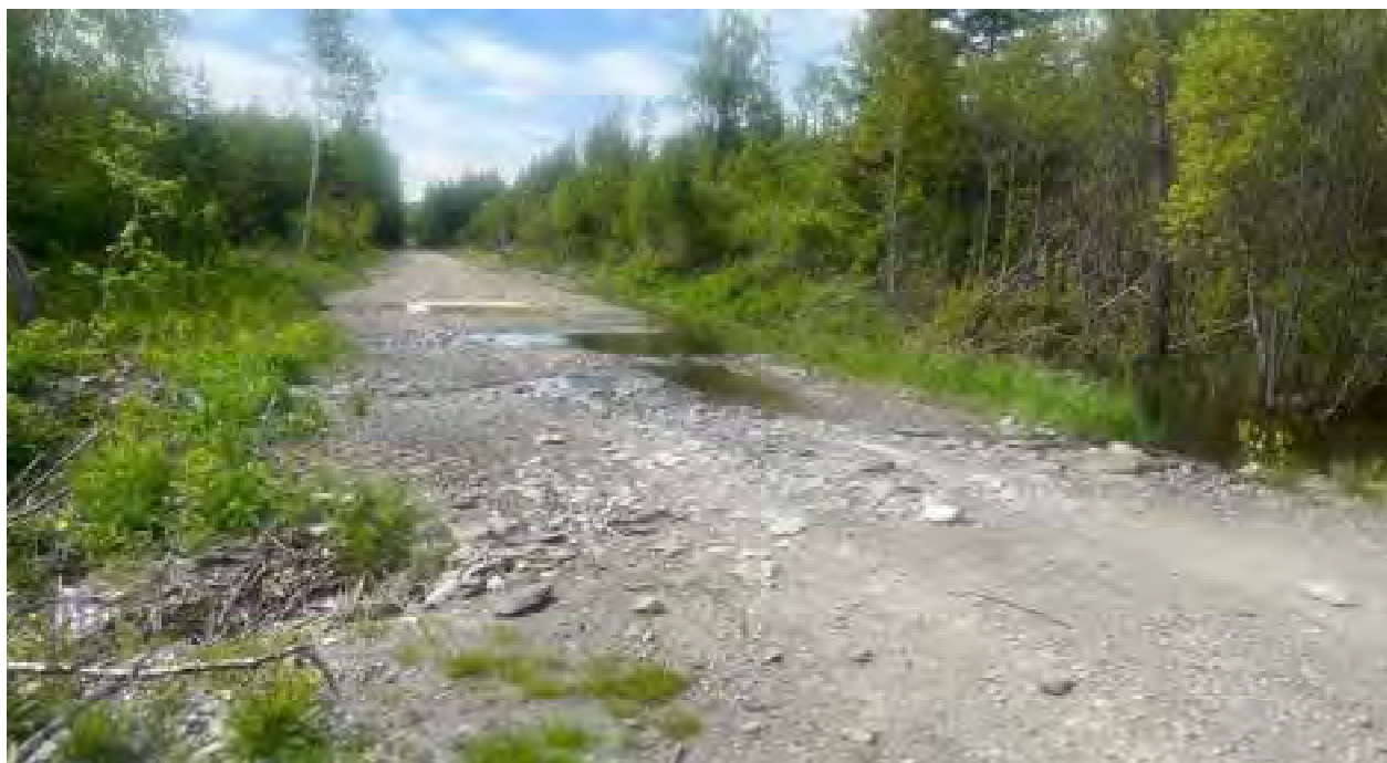
Chemin inondé suite à l'affaissement de ponceaux (47.45717, -68.50142)
