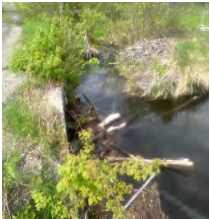
Ponceau partiellement bloqué par les débris d'un barrage de castor à proximité, causant une inondation du chemin (47.41537, -68.51985)
