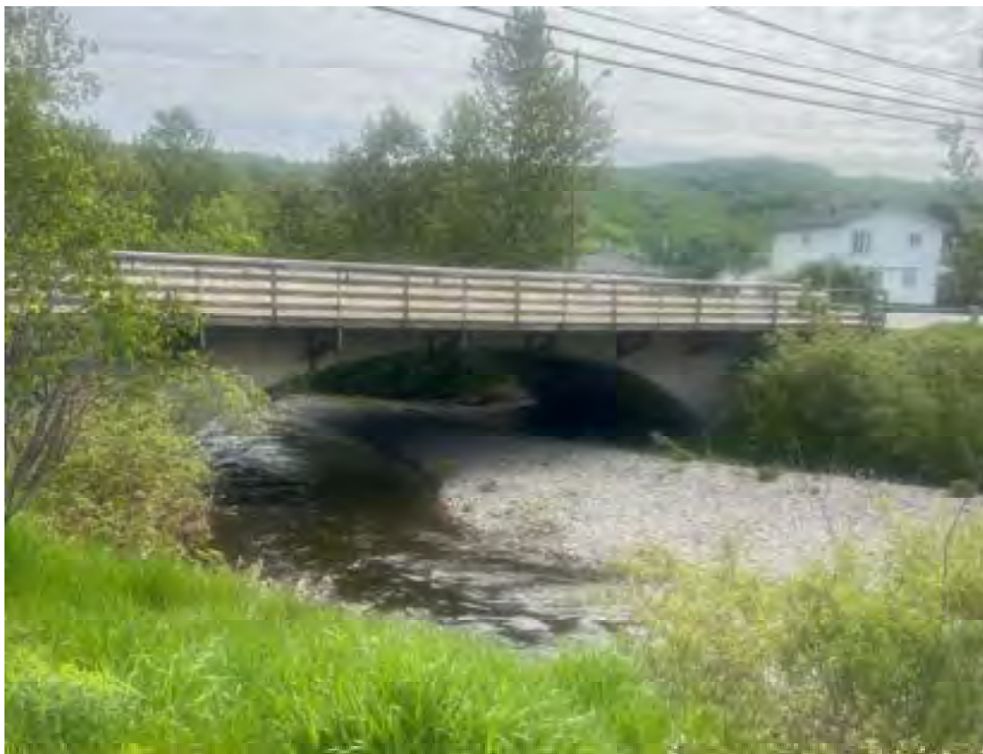
Banc de sédimentation problématique près du pont sur le boulevard Isidore-Boucher (47.42569, -68.38308)
