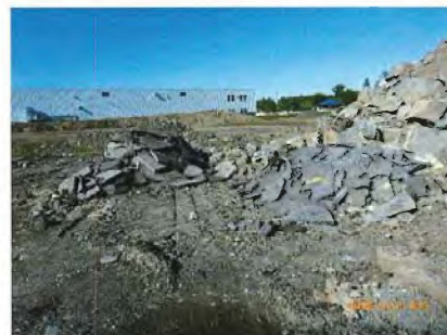
P1040789.JPG Photo 6. Amas d'asphalte
