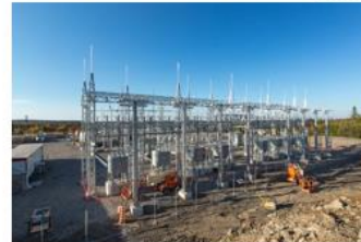
Poste électrique du projet
