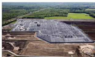
Poste Judith-Jasmin à 735-25 kV, à Terrebonne
