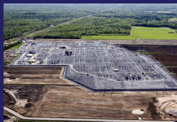
Poste Judith-Jasmin à 735-25 kV, à Terrebonne
