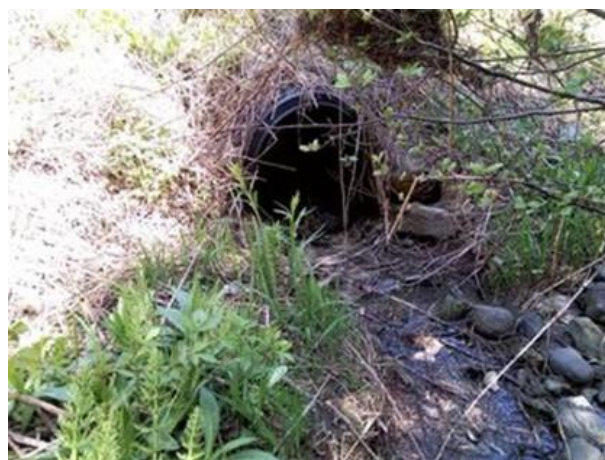
Photo 10. CE6, ponceau simple en plastique (SH041)
