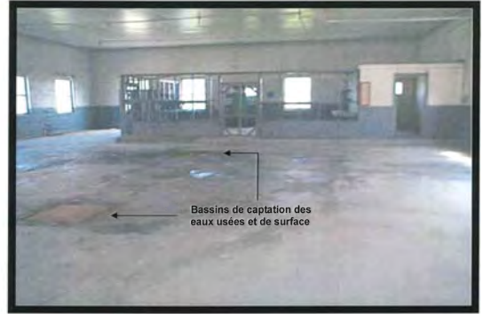
PHOTOGRAPHIE # 23: Partie du bâtiment ayant servi comme garage de mécanique. Surface localement tachée de produits pétroliers.
