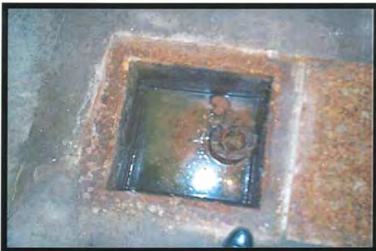
PHOTOGRAPHIE # 25: Bassin de captation des eaux usées et de surface dans l'ancien garage.
