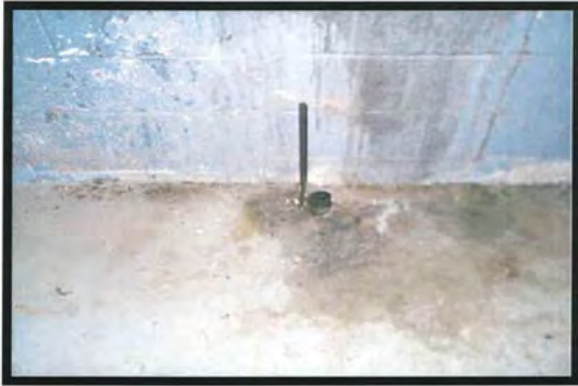
PHOTOGRAPHIE # 29: Ancienne conduite pour l'évacuation de l'huile usée. Mur taché de produits pétroliers. Intérieur de l'ancien garage au coin nord.
