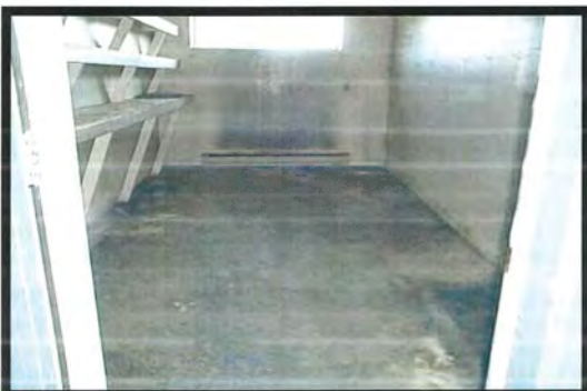
PHOTOGRAPHIE # 24: Coin est du bâtiment (remise probable). Dalle de béton tachée localement de produits pétroliers.
