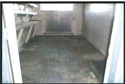
PHOTOGRAPHIE # 26: Coin est du bâtiment (remise probable). Dalle de béton tachée de produits pétroliers.
