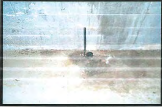
PHOTOGRAPHIE # 27: Ancienne conduite pour l'évacuation de l'huile usée. Mur taché de produits pétroliers. Intérieur de l'ancien garage au coin nord.
