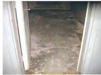
Photo 4 : 11-10-2007 Taches d'hydrocarbures sur la dalle de béton du plancher. Vue vers l'est.
