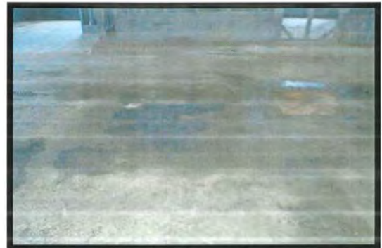
PHOTOGRAPHIE # 22: Vue rapprochée de la surface de la dalle tachée de produits pétroliers dans l'ancien garage.
