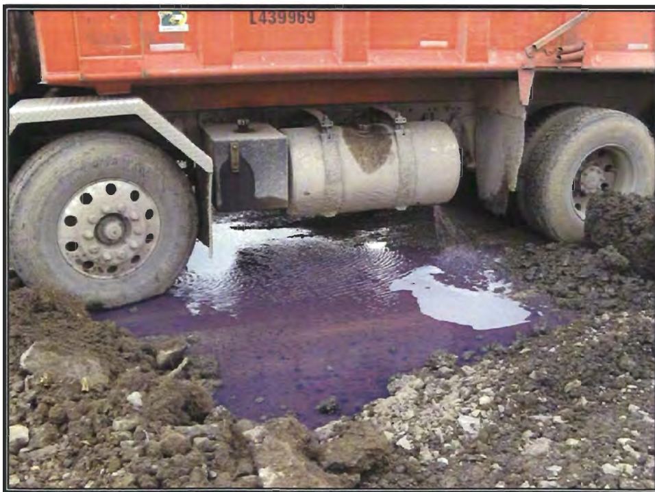
Photo 10 : Déversement accidentel lors d'un bris d'un réservoir d'un camion.
