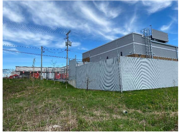
PHOTO 7 Génératrice observée sur le terrain adjacent au nord du lot 6 573 742
