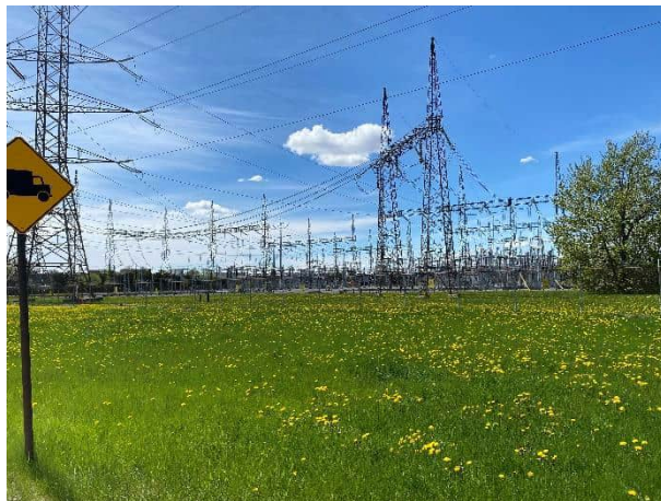
PHOTO 31 Poste électrique Notre-Dame situé au 1505, rue des Futailles
