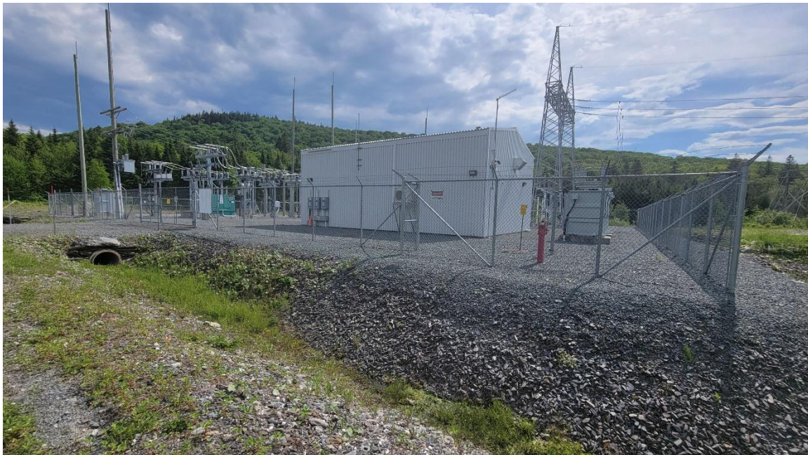
Figure 1 - Poste électrique similaire à celui qui sera aménagé sur la rue Pie-XI
