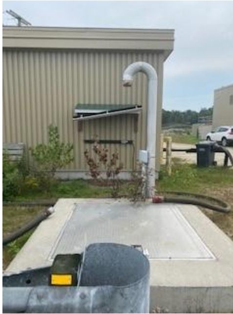
Figure : Évent du réservoir souterrain de boues de fosses septiques
