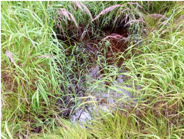
Photo 3 : Saturation d'eau observée à la station ST07B
