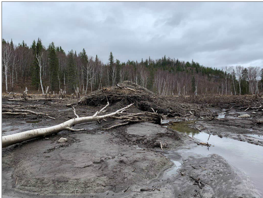
Photo 32 : Brèche dans un barrage du secteur des étangs de castor aux IGRM
