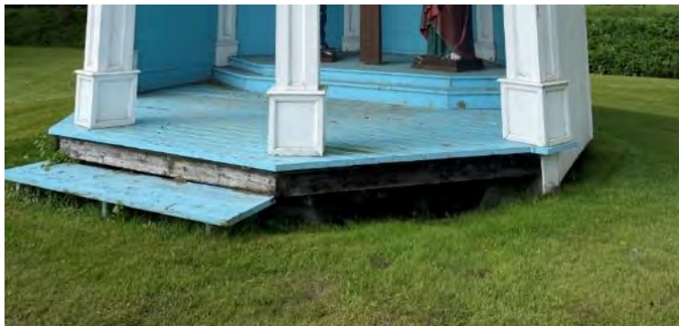
Figure 3.29 La structure du plancher n'a plus de protection contre l'humidité et la marche avant n'est plus fixe. Aucun système de drainage n'est en place (source: FL)
