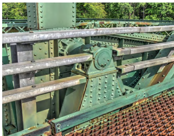
Figure 3.11 Vue du pivot côté nord – Juillet 2019 (Source : Avec l'autorisation de Nathan Holth)
