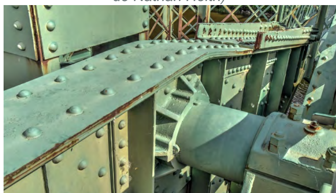
Figure 3.9 Vue du pivot côté nord – Juillet 2019 (Source : Avec l'autorisation de Nathan Holth)
