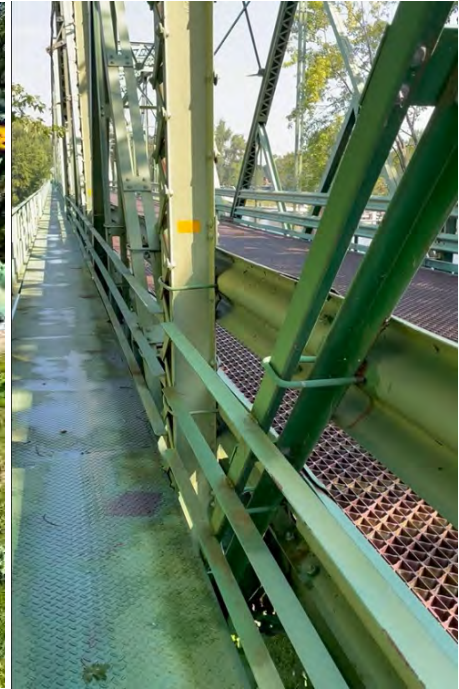
Figure 3.6 Vue de passage pour piétons et du plancher en fer – Août 2023 (Source : FL)
