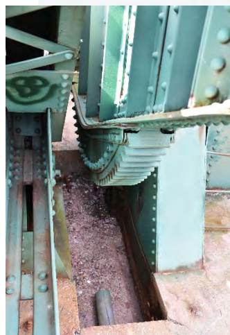
Figure 3.8 Mécanisme qui permettait de lever la bascule centrale – Juillet 2019 (Source : Avec l'autorisation de Nathan Holth)
