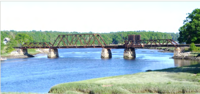
Figure 3.17 Pont de train sur la rivière St-George à South Thomaston, Maine construit en 1921 - Juillet 2012 (Source : Avec l'autorisation de Nathan Holth)
