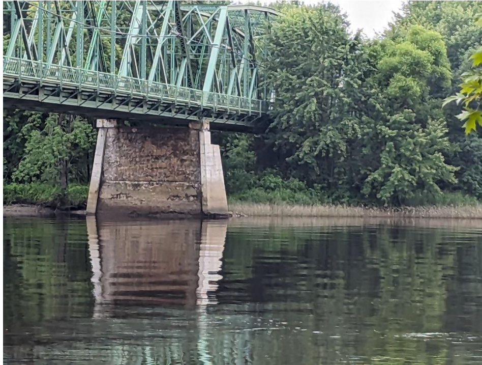
Photographie 5 : Rive droite. Érosion de la rive en aval du pont de Batiscan et accumulation de sédiments avec végétation aquatique en amont.
