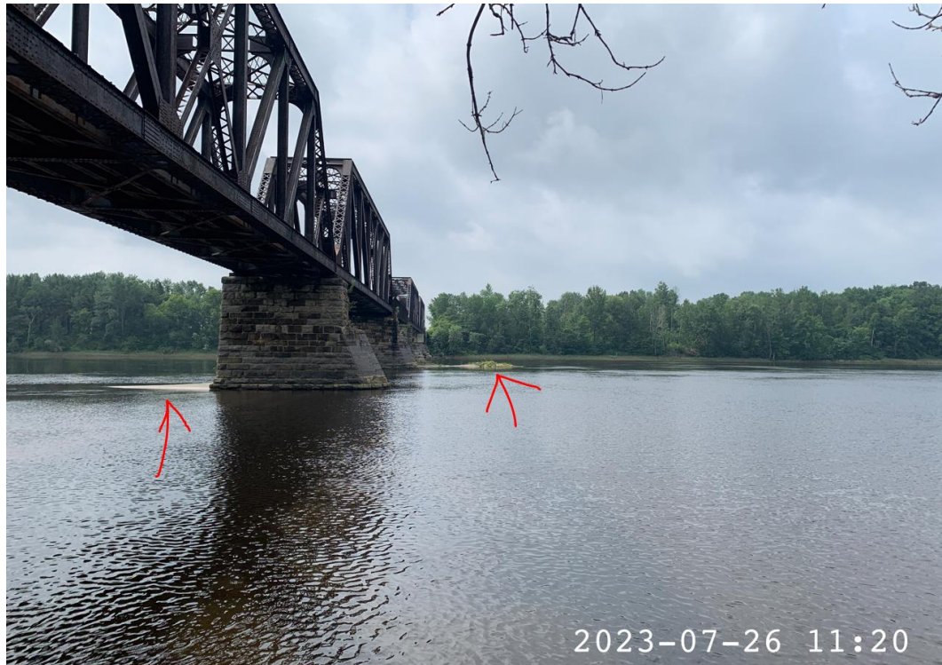
Figure 3.10 : Bancs d'accumulation sous le pont ferroviaire
