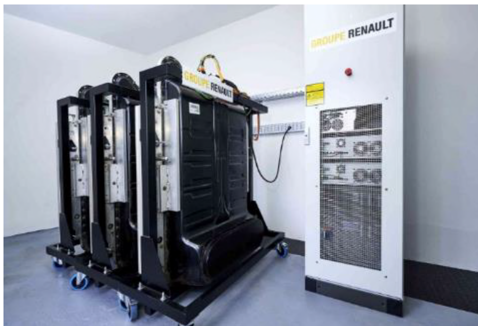
Figure 21 Stockage d'énergie stationnaire par d'anciennes batteries de VÉ (source : Groupe Renault)
