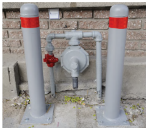
Figure 23 Poteaux de protection pour les équipements gaziers (source : energir.com)
