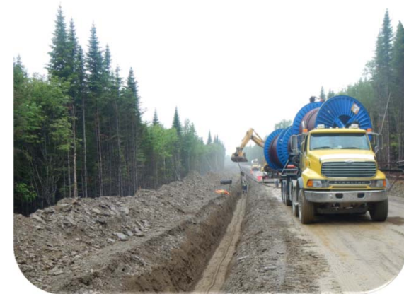
Réseau collecteur et poste de raccordement
