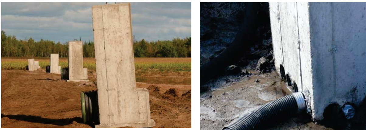
Figure 11. Structure de contrôle de nappe phréatique
