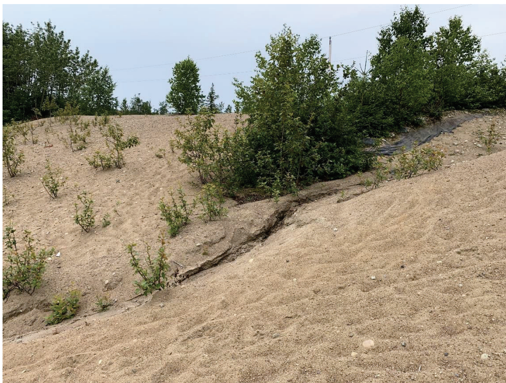
Figure 3-9 : Zone de ravinement 2 (aval)
