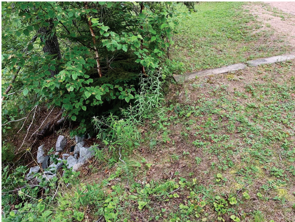
Figure 3-22 : Zone d'érosion mineure en sommet de talus
