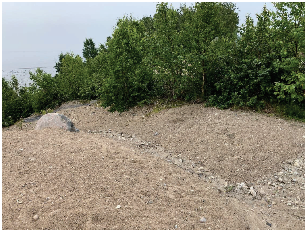
Figure 3-8 : Zone de ravinement 2 (amont)
