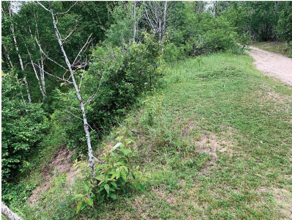
Figure 3-21 : Zone d'érosion mineure en sommet de talus
