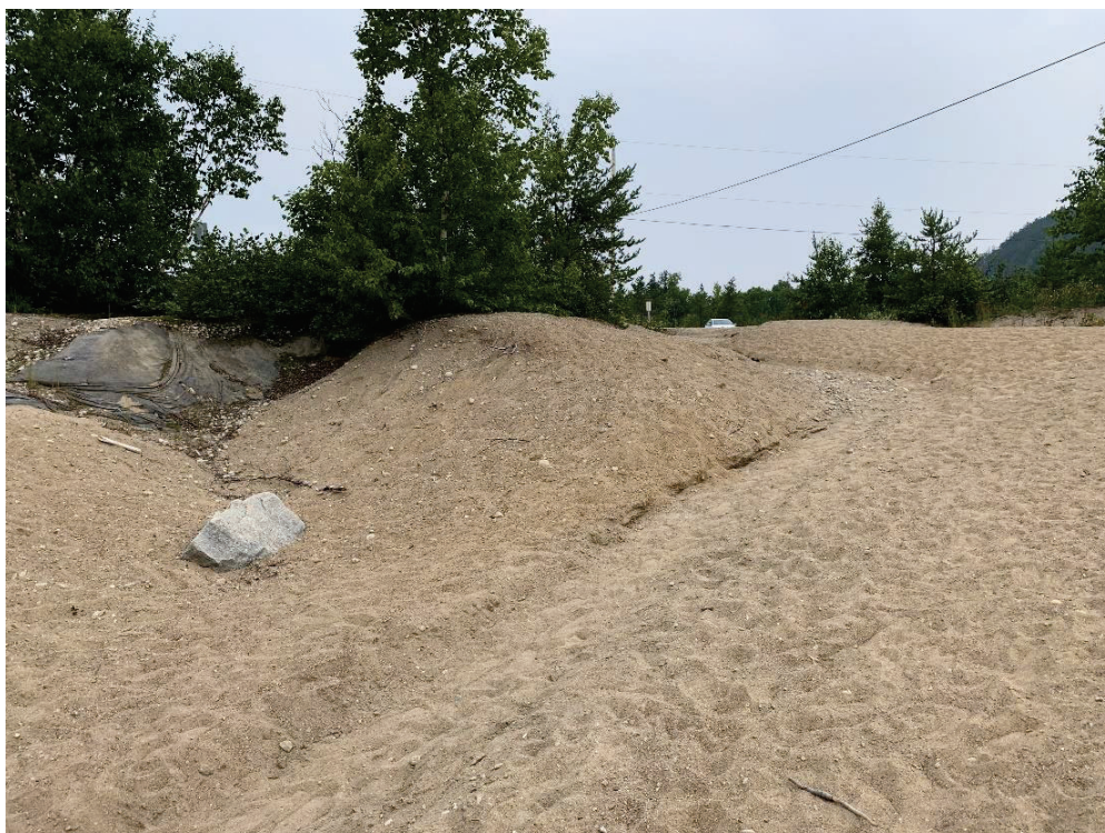
Figure 3-7 : Zone de ravinement 1 (aval)
