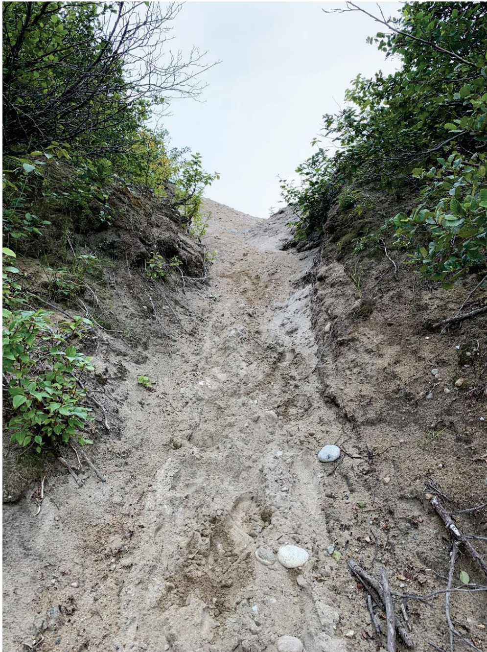
Figure 3-19 : Zone de ravinement 5 (milieu et aval)
