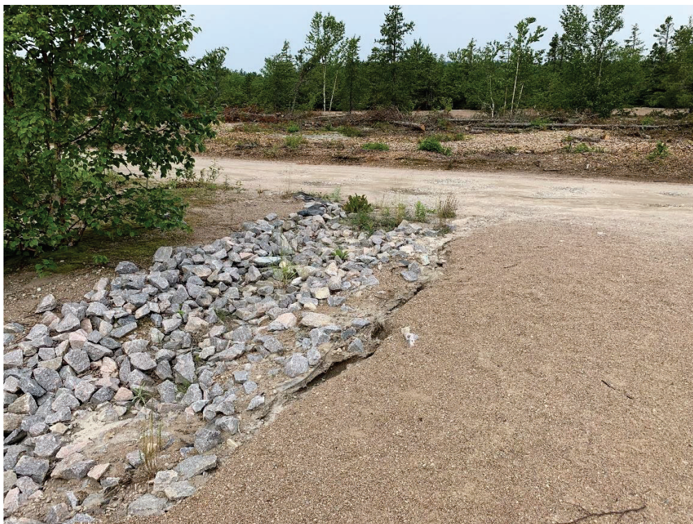
Figure 3-2 : Vue du sommet de talus - Zone de ravinement 3
