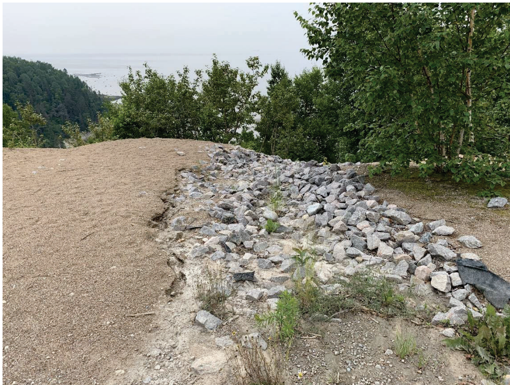
Figure 3-10 : Zone de ravinement 3 (amont)
