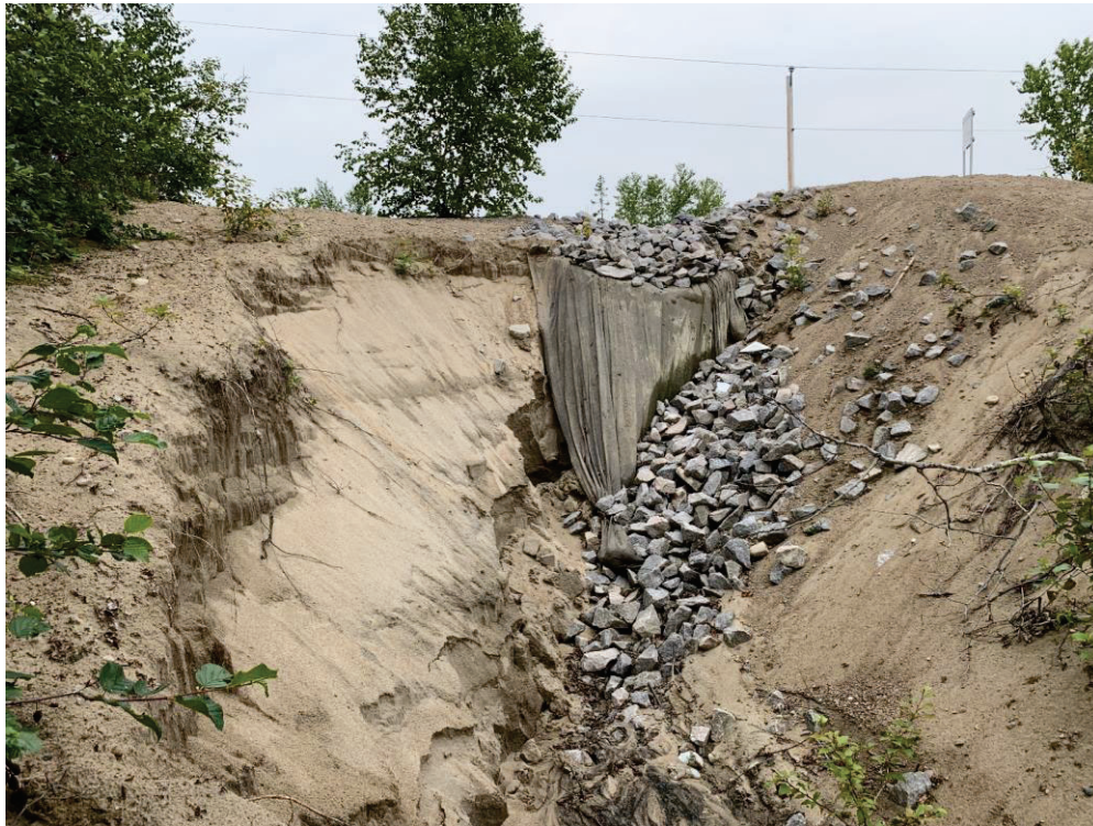
Figure 3-5 : Effet de bout à l'extrémité de l'enrochement - Zone de ravinement 3
