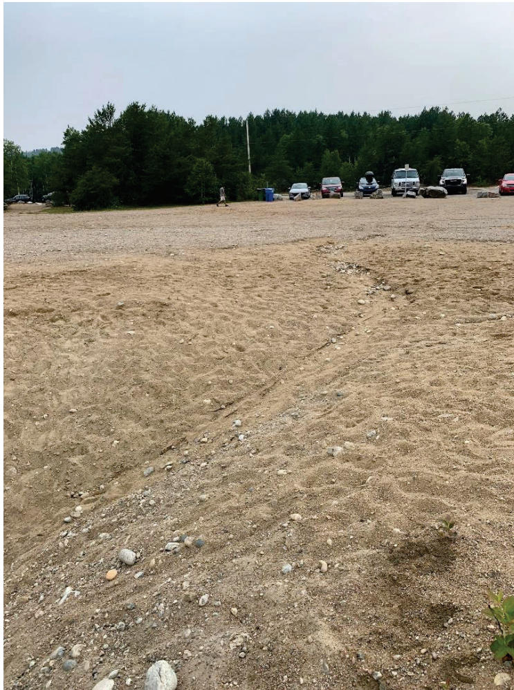
Figure 3-4 : Vue du sommet de talus - Zone de ravinement 5
