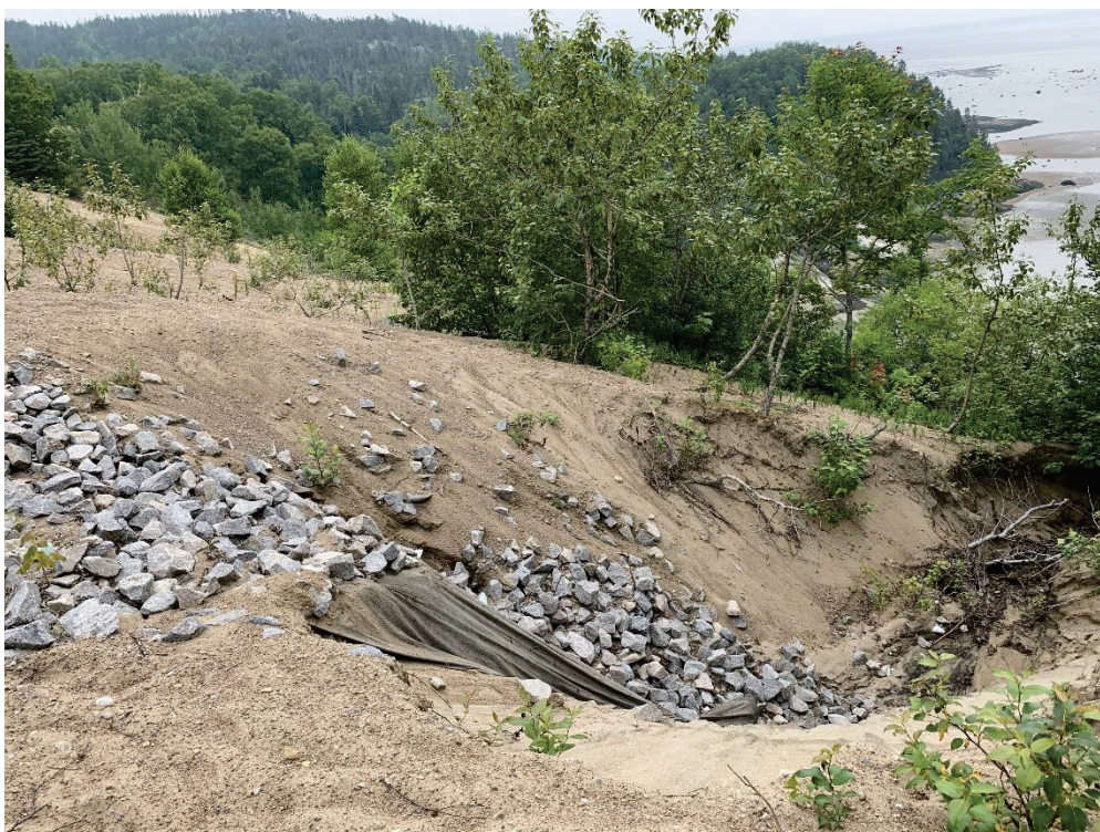
Figure 3-11 : Zone de ravinement 3 (amont)
