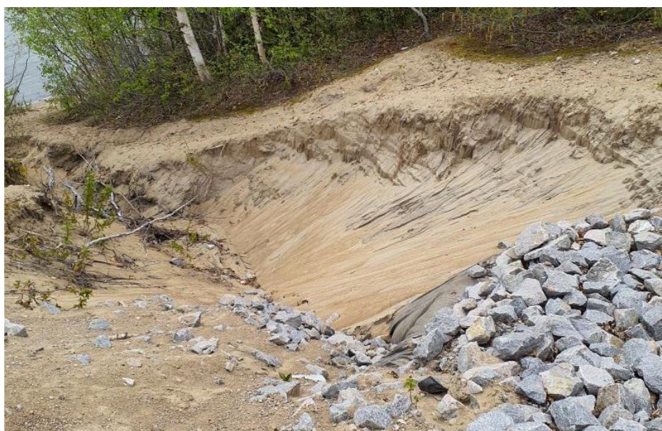
Figure 7 Glissement de terrain sur le talus inférieur (mai 2023).
