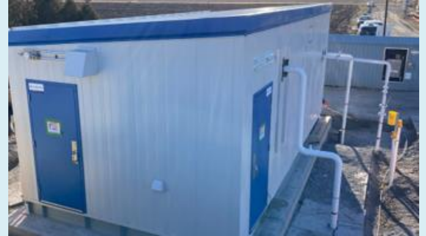
Exemple de poste d'injection
