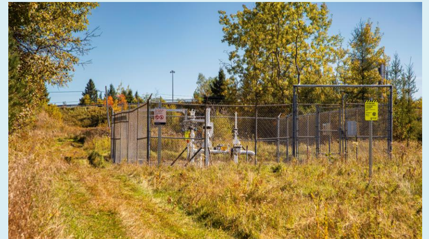
Exemple de poste de vanne
