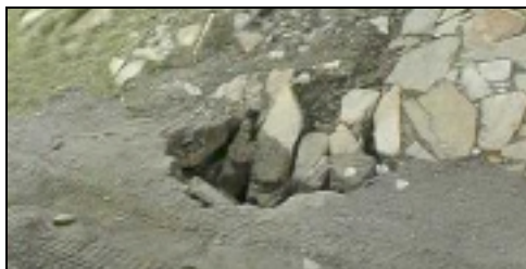
Photo 6-9 – Des dommages importants au talus causés par la circulation des VHR
