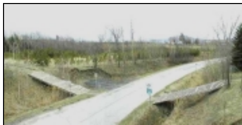
Photo 6-10 – Accès à un sentier de VHR non conforme aux normes du MTQ
