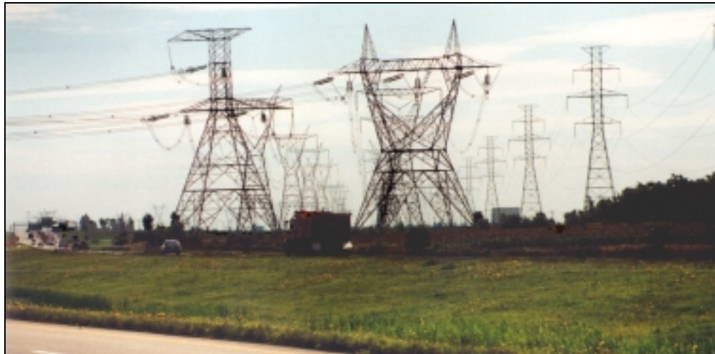
Photo 5-7 — Lignes de transport d'Hydro-Québec, A-30, Boucherville
