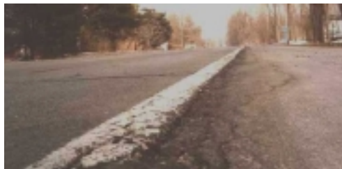
Photo 6-2 – Problème de fissuration entre l'accotement asphalté et la chaussée
