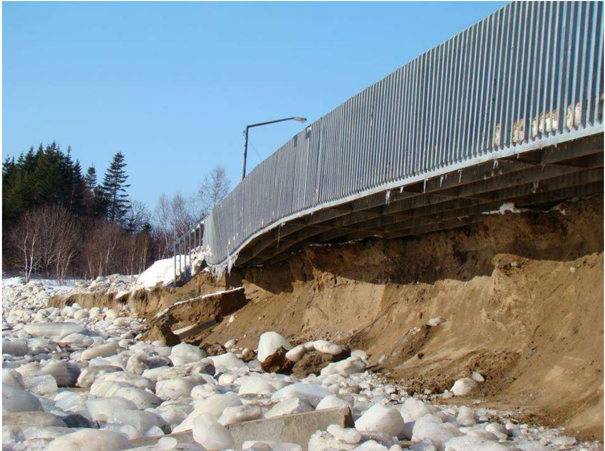
La promenade de bois en bordure de la rue des Rochelois a dû être démantelée après avoir été sévèrement endommagée par les tempêtes de décembre 2016.
