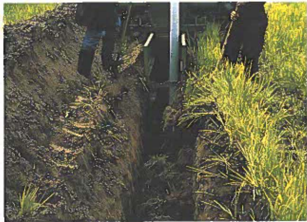
Photo MEF Installation de drains souterrains dans une parcelle de terre agricole
