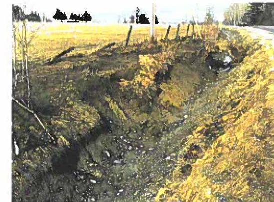
Photographie no 1 : Section nettoyée à l'été 1995 selon la méthode traditionnelle. Cette photographie prise au printemps 1996 permet de constater les effets dévastateurs de l'érosion (solifluxion et décrochage) sur les talus du fossé. (Route 222-01-140, vue vers l'est) (Photo: RAPPEL)
