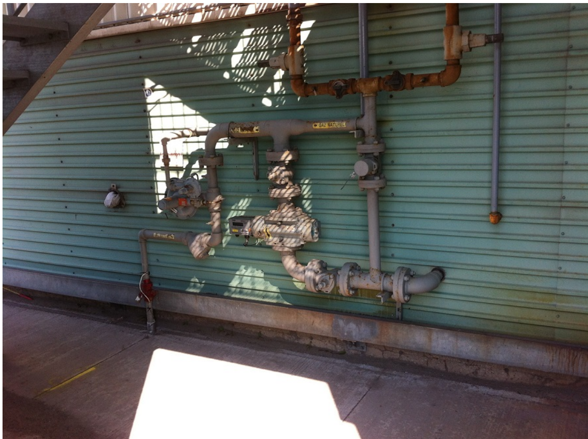
Figure 5 – Point d'entrée du réseau de Gaz Métro à l'incinérateur.
