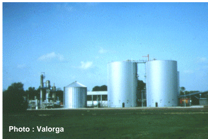
Figure 7-2-1 Installation de digestion anaérobie de Mons, Belgique
