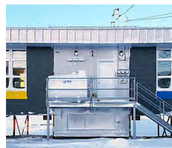
Figure 8 : Installation de chauffage au mazout
