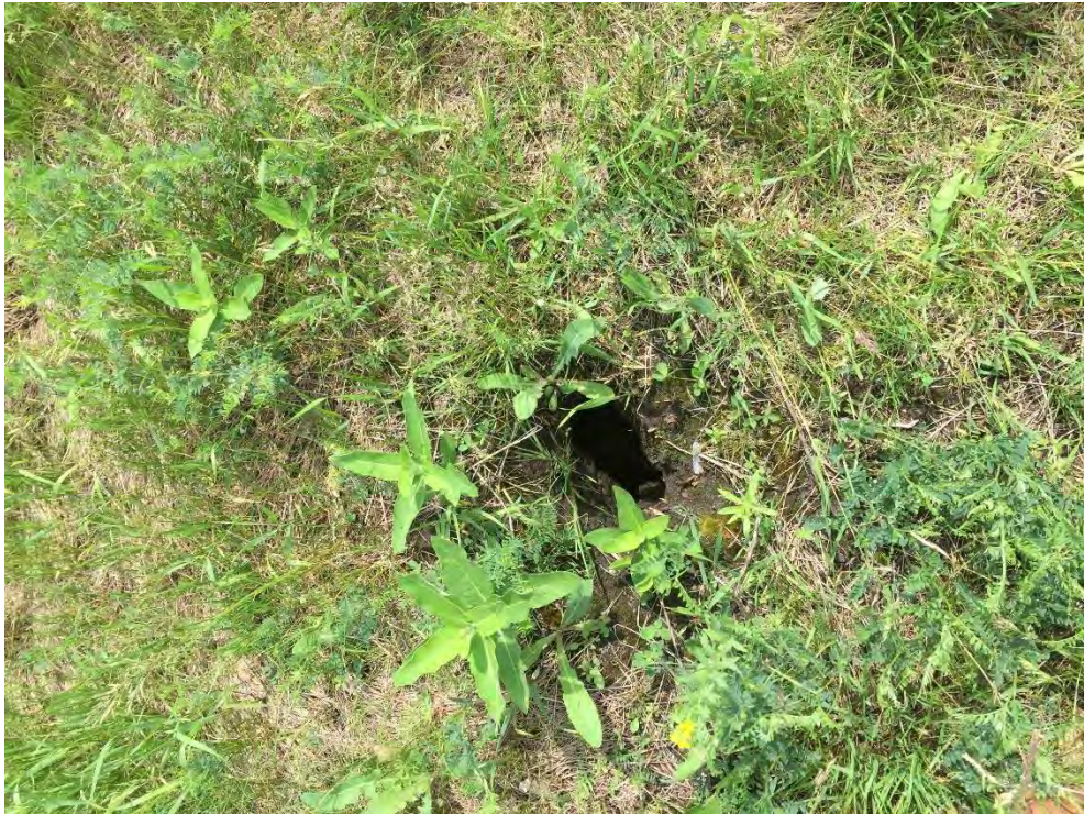
Photo 10 - Présence de trou en haut de talus sur le terrain plat (2017-06-20)
