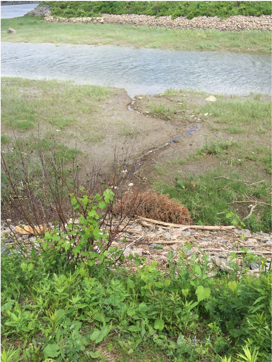
Photo 17 - Coulée d'eau s'était formée à la sortie du tuyau de tôle ondulée (TTOG) désaffecté (2017-06-20)
