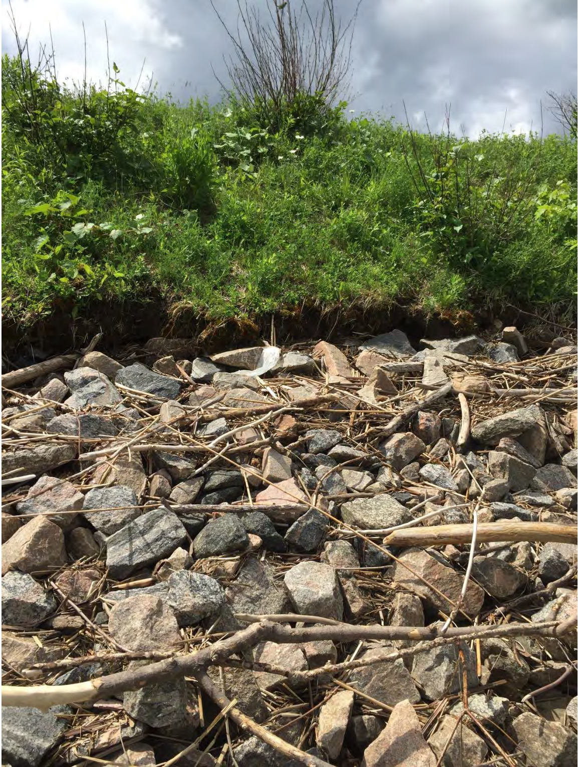
Photo 18 – Encoche s'étant formée à la jonction de l'enrochement et du talus végétalisé (2017-06-20)
