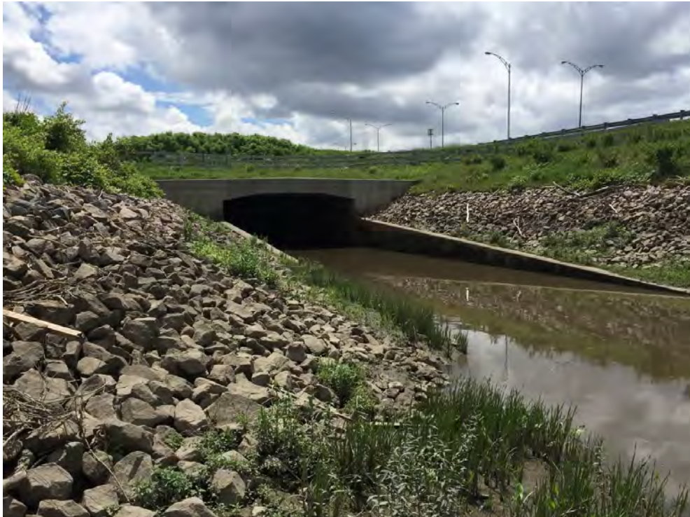
Photo 12 - Portique (sortie du ruisseau du Moulin) (2017-06-20)
