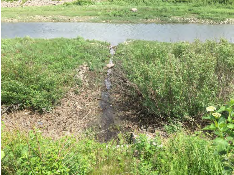
Photo 13 - Tête d'un ponceau et le chenal d'écoulement à la sortie d'une conduite (2017-06-20)
