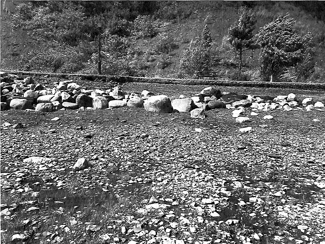
Photo 1 – Érosion et effondrement de l'enrochement existant
