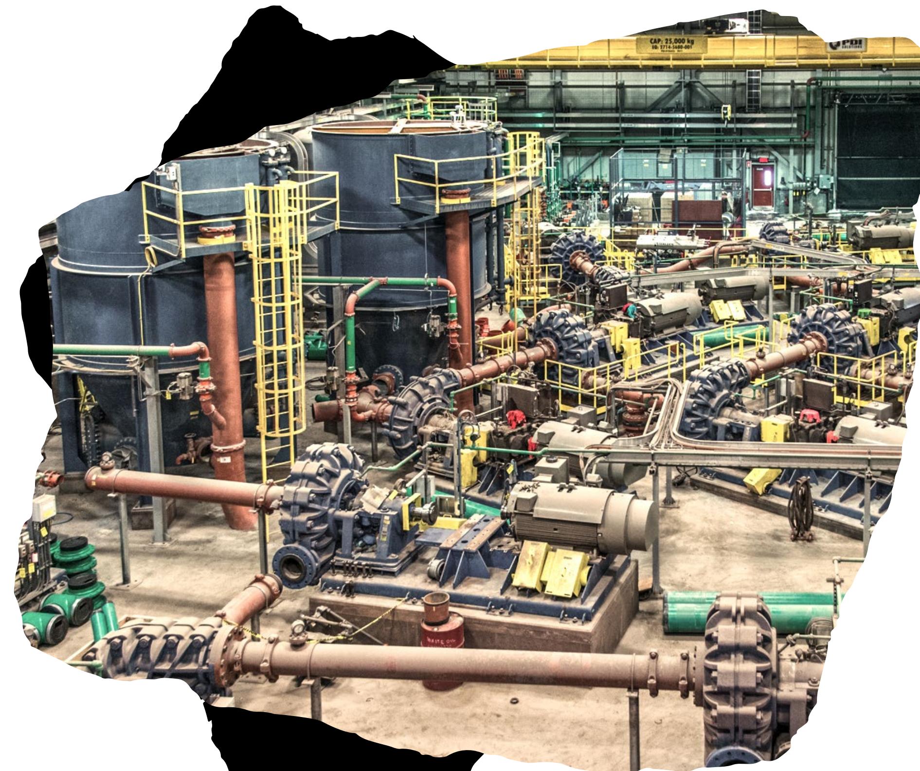
Station de surpression utilisée pour pomper les résidus miniers
