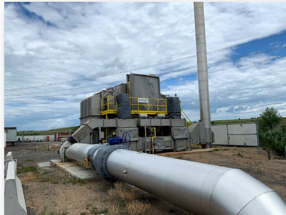
Technologie d'oxydation thermique régénérative (OTR) BIOTOX® pour traiter les émissions de l'usine de production de biométhane (2019)
