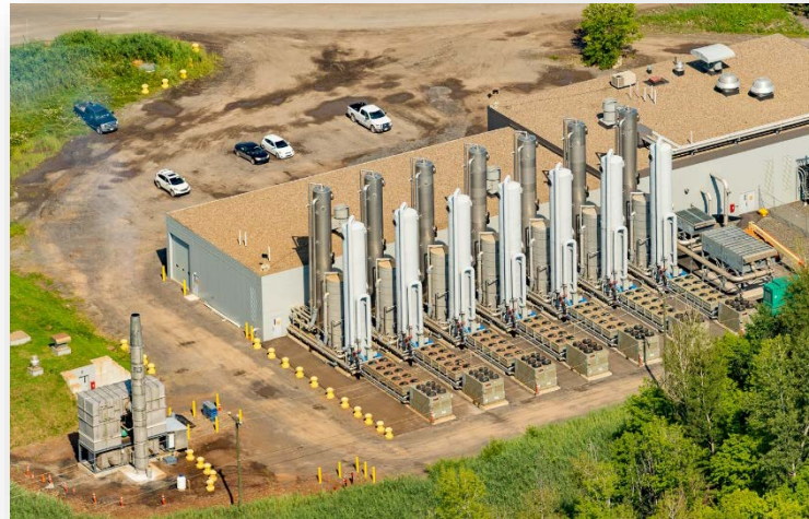
Usine de production de biométhane (depuis 2014)
