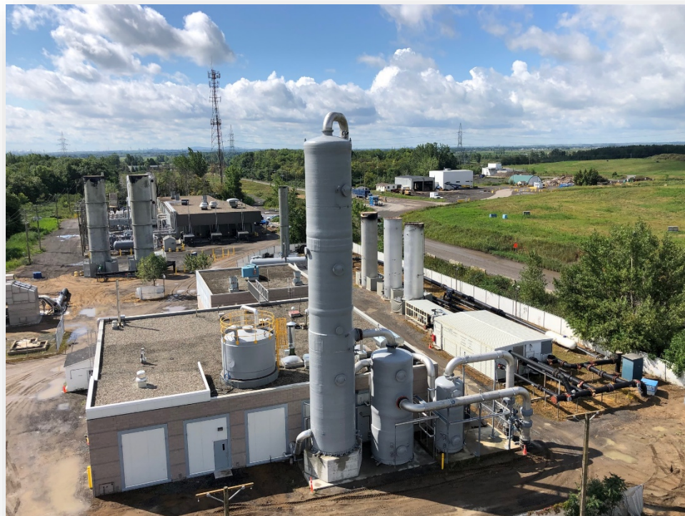
Technologie de désulfuration ( \text{H}_2\text{S} ) du biogaz à l'usine de production de biométhane (2019)
