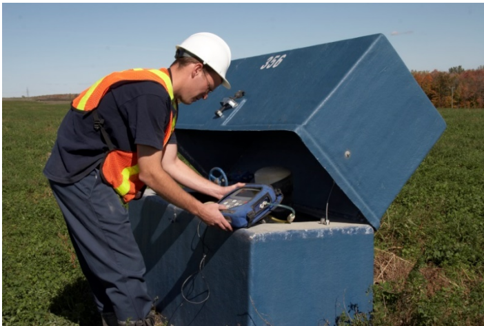
Suivi et optimisation de l'efficacité du réseau de captage des biogaz
