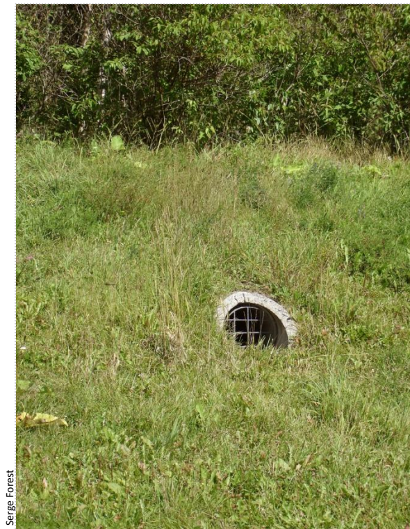
BASSIN CHAVANNES N° 88 EXEMPLE EXUTOIRE RÉSEAU MAJEUR
