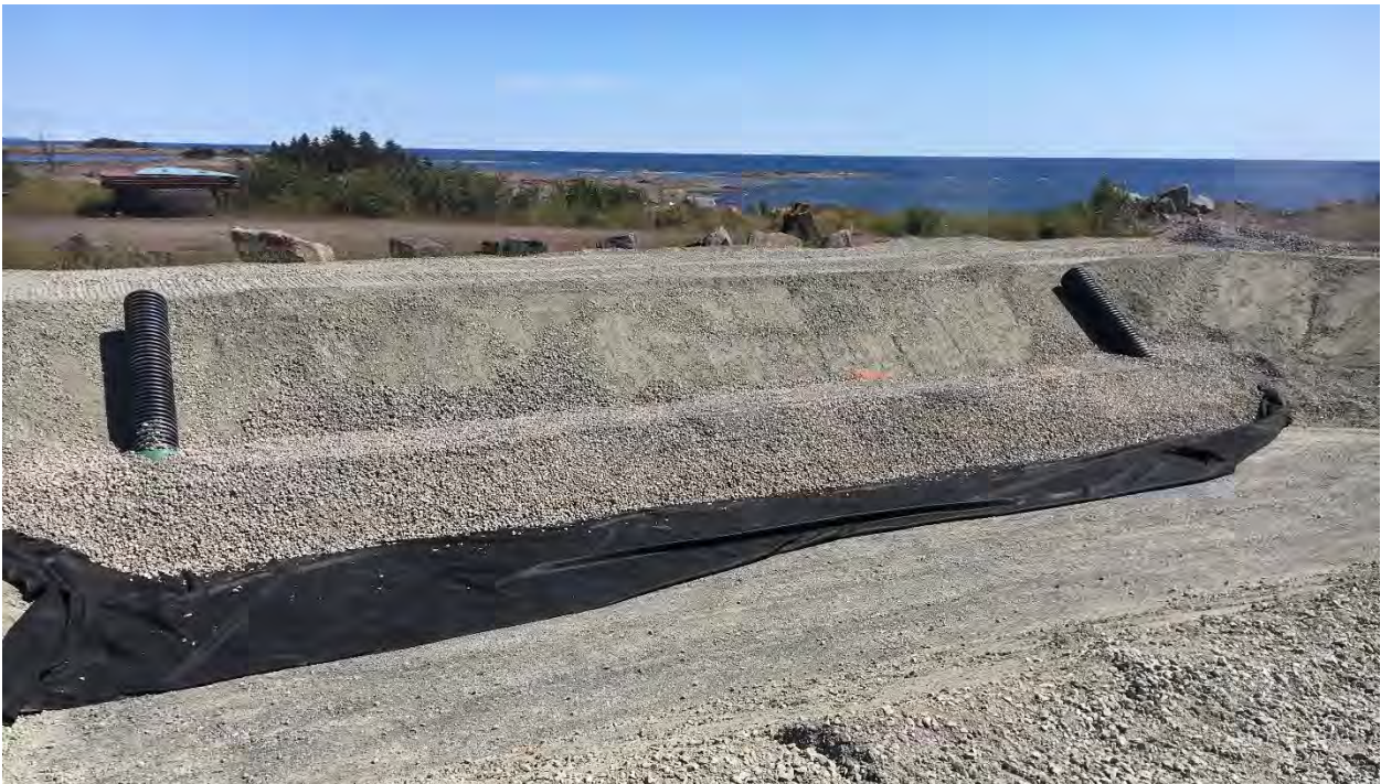
Photo 4-2. Système de drainage d'une cellule
