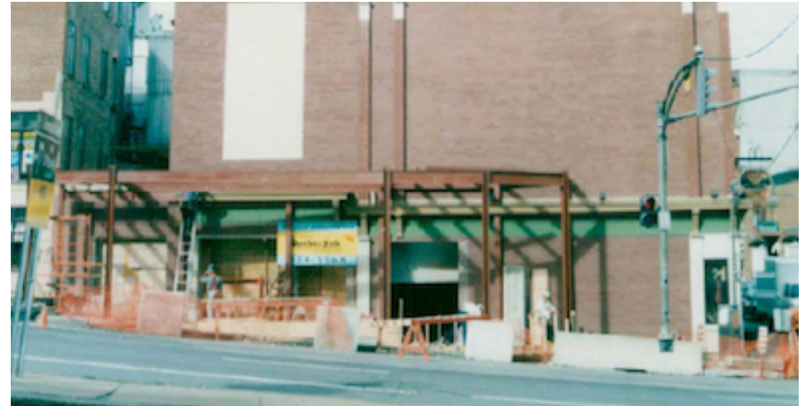
Le 810, avenue Honoré-Mercier en cours de construction en 1996. Photo : Répertoire DHN, Ville de Québec
