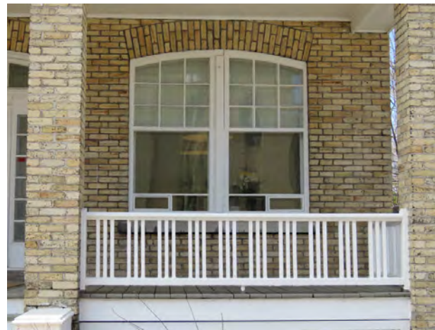
Garde-corps dont les barreaux sont disposés en triplets. Fenêtres jumelées en arc plein cintre. 990, avenue Holland.
