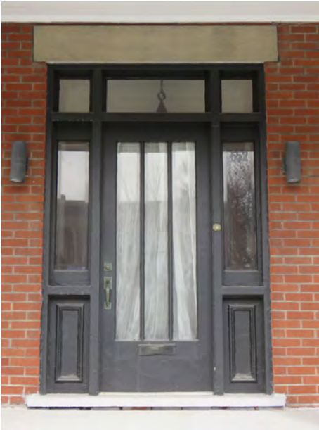
Porte à baies latérales et à imposte tripartite. Linteau en pierre. 652, boulevard René- Lévesque Ouest.
