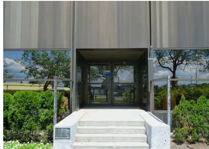
Détail du revêtement d'aluminium refoulé anodisé et des cadres métalliques de fenêtres. Entrée sud.
