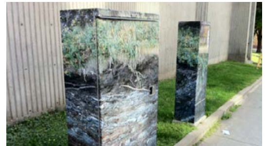
Figure 29 : Boîtes électriques peintes
