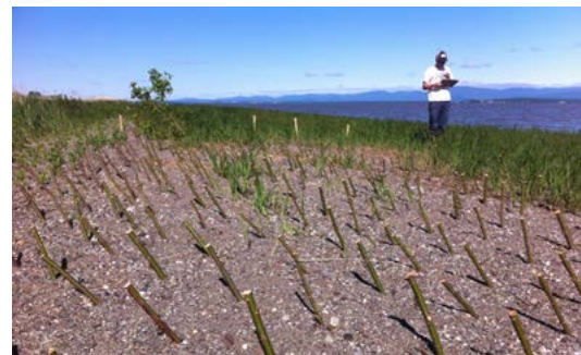
Figure 13 : Protection des berges contre l'érosion
